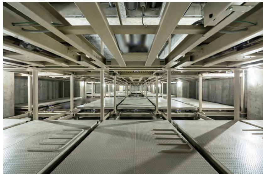
駐車場格納部
