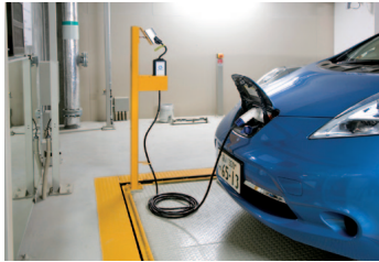
乗込み口で充電スタンドに接続。
