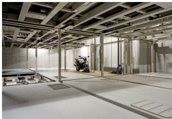
地下循環部での自動二輪トレー
