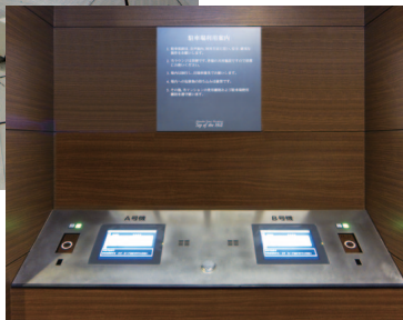
遠隔操作ラウンジに設置された操作パネル
