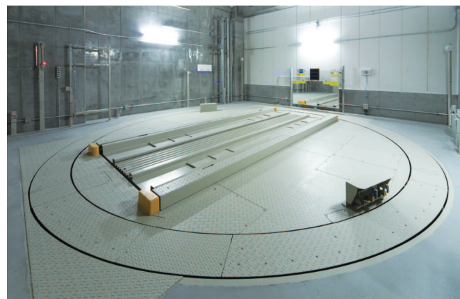
A・B号機内蔵型ターンテーブル
