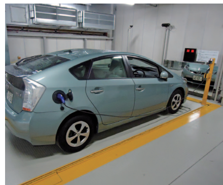
充電トレーを2基設置
