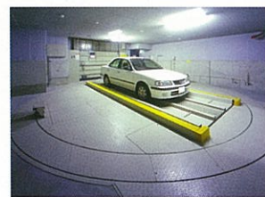
2号機の入出庫口にあるターンテーブル。出庫時には、出庫専用口に向け約30度ほど回転する。
