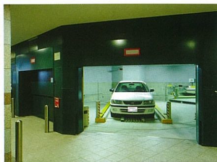
2号機の入出庫口は、入庫専用口から約30度ほどシフトした位置に出庫専用口を設け、入出庫待ちの車の導線を分離させている。
