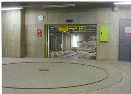
地下2階の駐車場に設置されたSPパークの出入庫口。1号機は大型乗用車にも対応している。スペース効率を重視した直接乗込型が採用され、出入庫口の前方にターンテーブルが配置されている。
