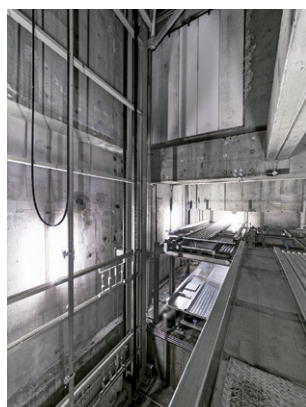
2層・16台収容の駐車スペース（写真 右:リフト部）
