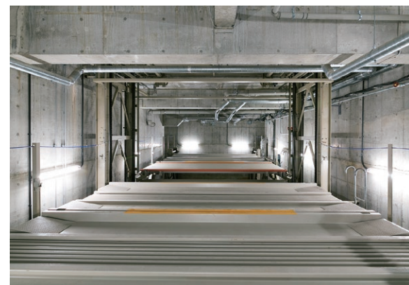
中間部にリフトを設けた2段・14台収容の地下スペース（写真は上段）
