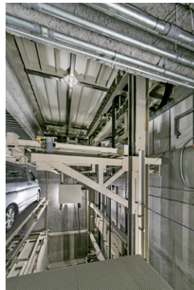
免震対応リフト(免震層下に待機)
