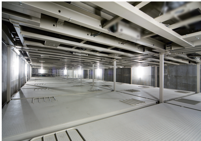
2層・39台の駐車室スペース(写真は下層)
