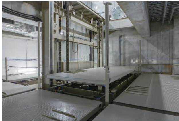
駐車場格納部 リフト部(フォークリフト)
