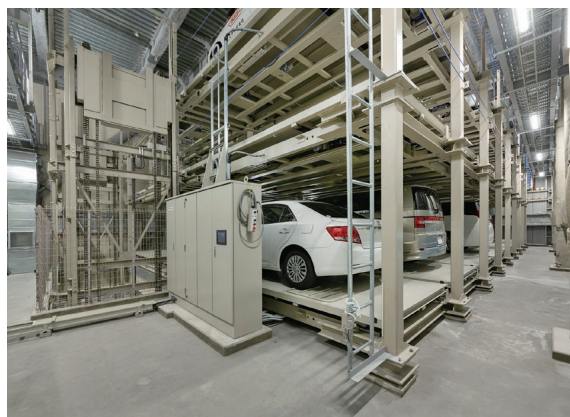
2F 機械駐車格納部
