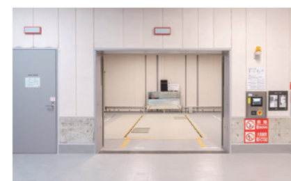
機械駐車 オートドア開時
