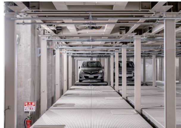
1号機 最下層端部よりリフト方向(上部配管 泡消火配管)
