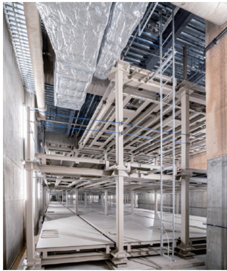
1号機奥側からリフト方向(最上段トレー配置無)
