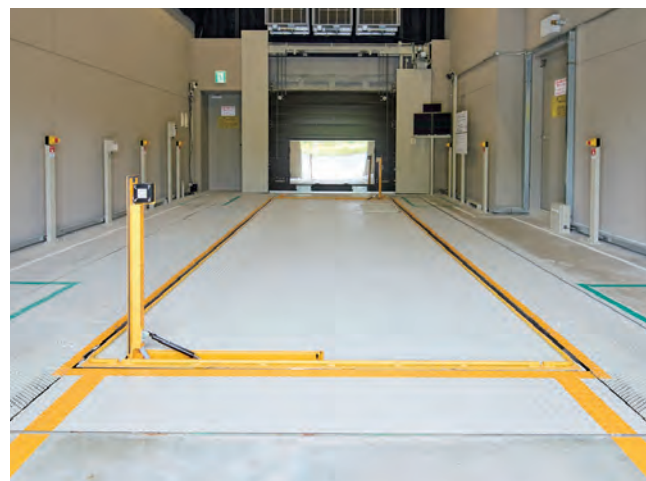
EV格納トレー（スタンド式トレー）正面
