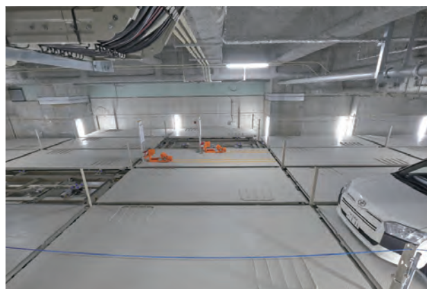
2層格納部(中央 自動二輪主用トレー)
